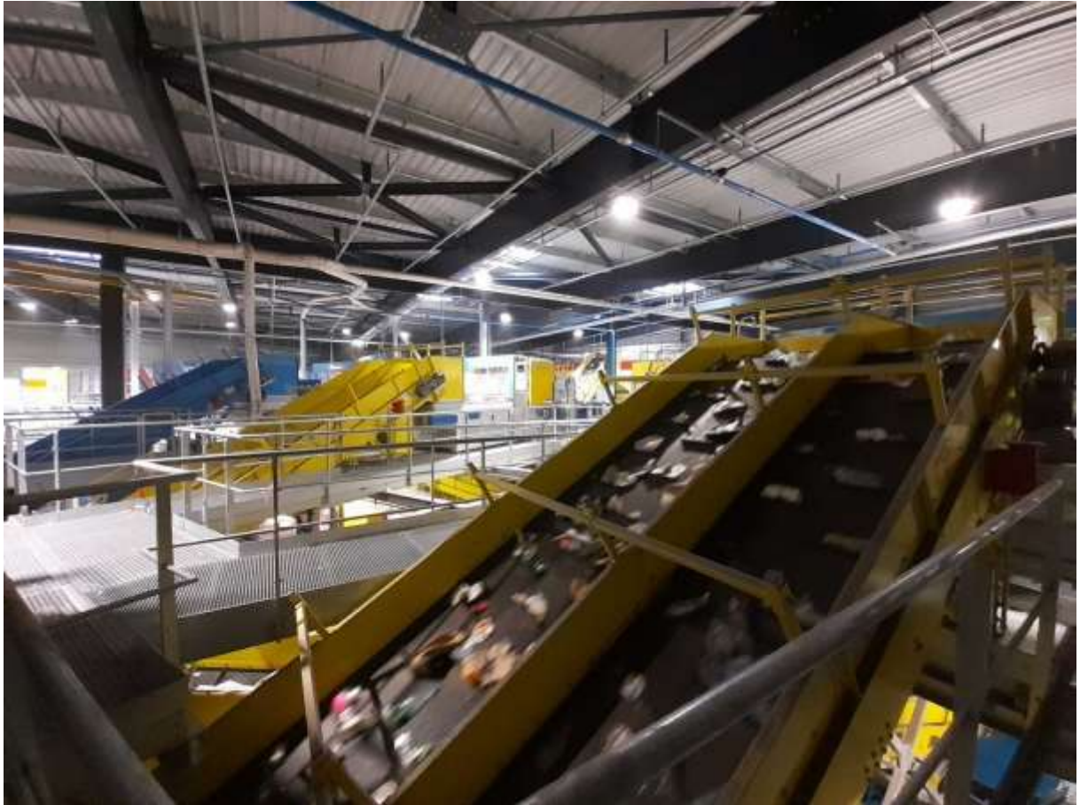
Centre de tri de Portes les Valence (pour le MM)
